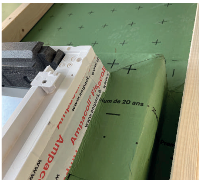
Mascheratura della membrana del sottotetto in corrispondenza del lucernario.
