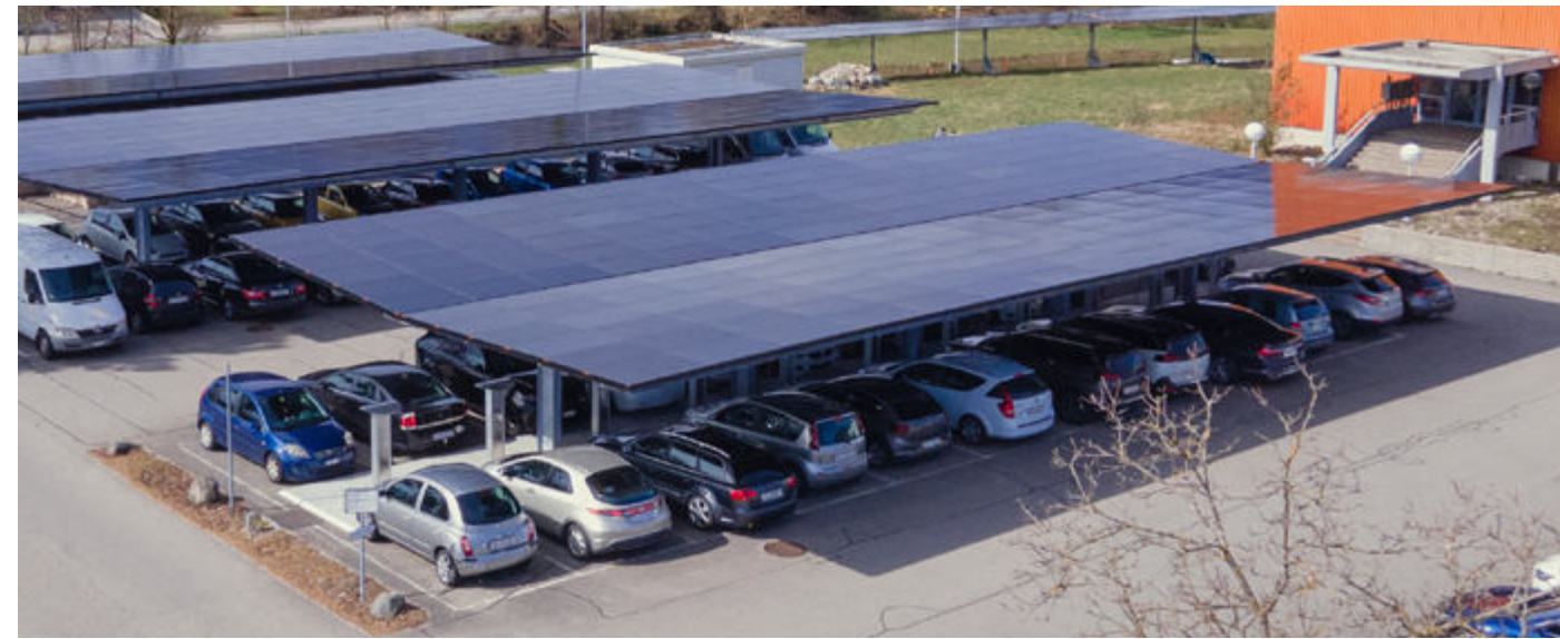
▲ Carport à Deitingen | Puissance de l'installation : 222 kWp
