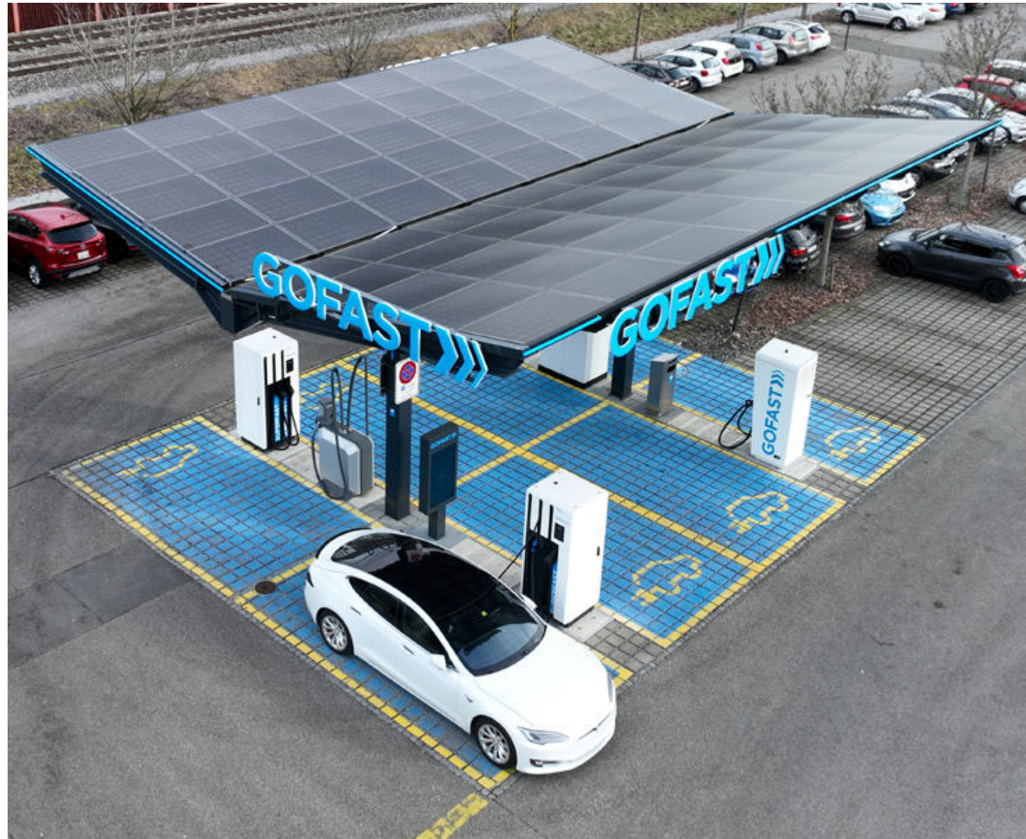
▲ Wingport à Oensingen | Puissance de l'installation: 34 kWp
