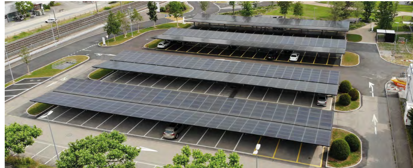
▲ Carport in Ebikon | Anlagenleistung: 328 kWp
