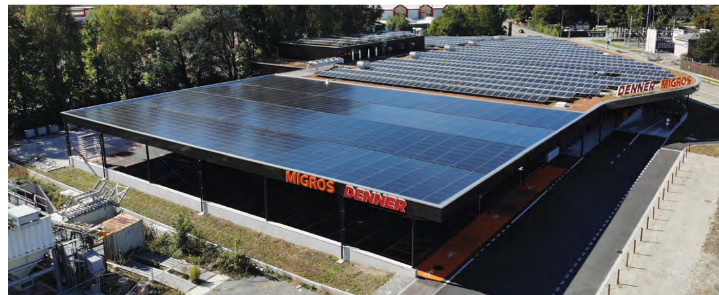
▲ Carport in Schlieren | Anlagenleistung: 294 kWp
