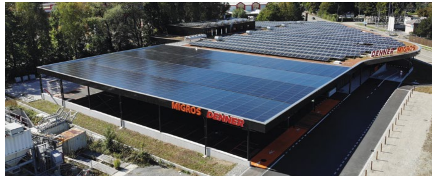
▲ Carport à Schlieren | Puissance de l'installation : 294 kWc
