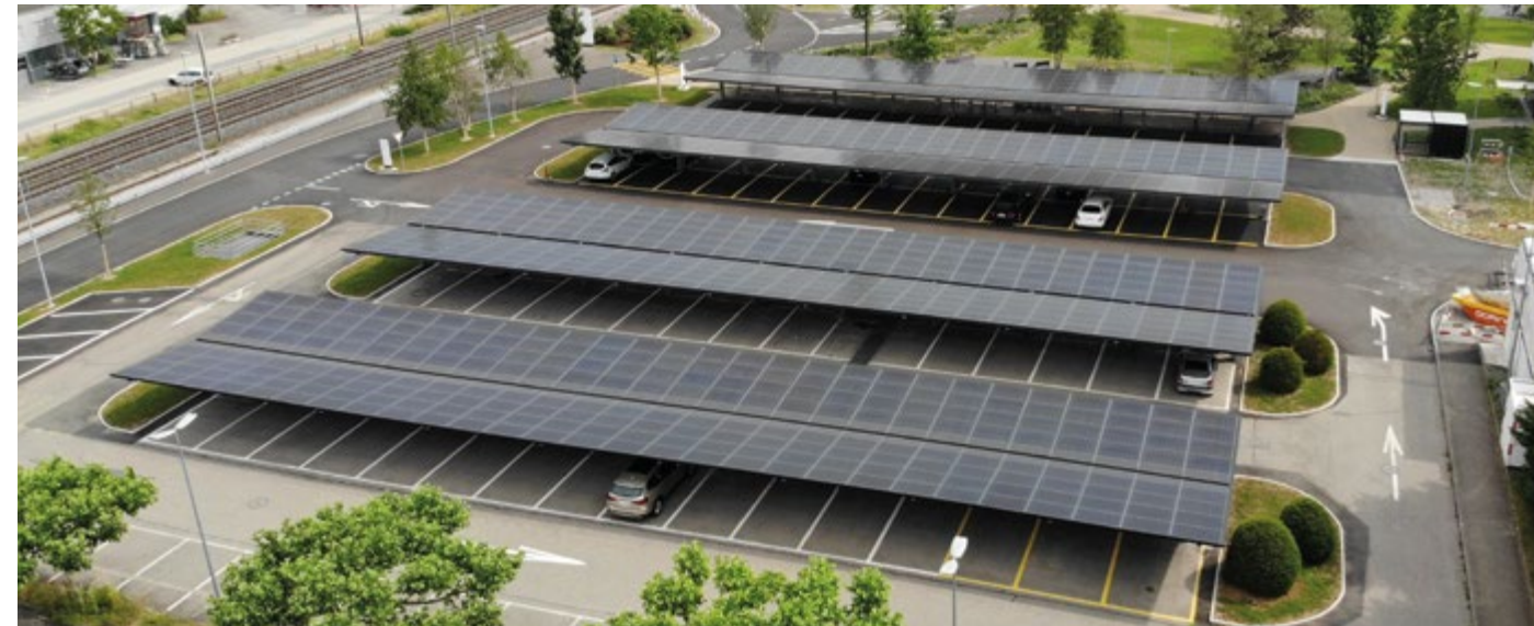
▲ Carport in Ebikon | Anlagenleistung: 328 kWp
