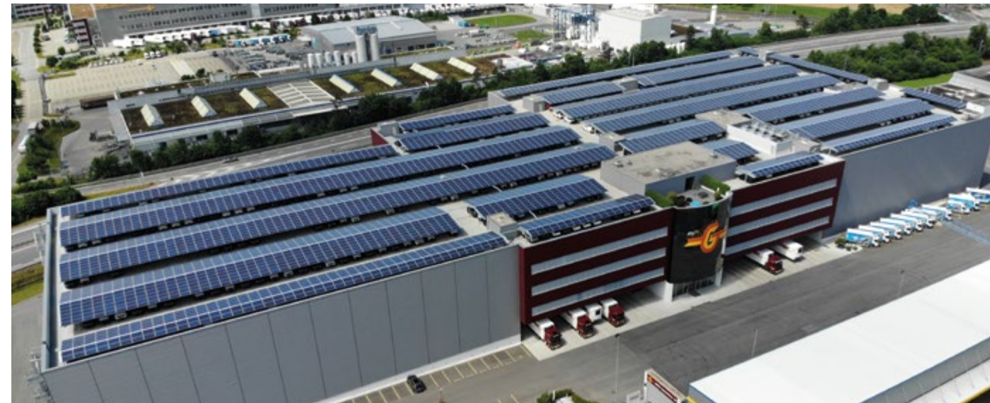
▲ Carport in Dagmersellen | Anlagenleistung: 1.8 MWp
