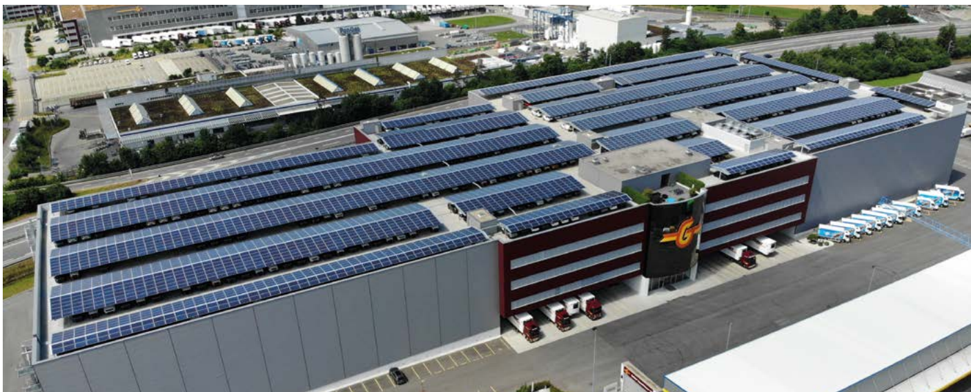
▲ Carport à Dagmersellen | Puissance de l'installation : 1.8 MWp
